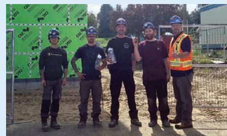
Les confrères Justin Hamann, Marc-André Potvin, Louis-Philippe Roy et Yan Richard, accompagnés du représentant syndical (libéré) Nicolas Parr, sur le chantier de l'école Sainte-Marguerite, à Trois-Rivières.
