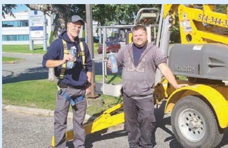
Les confrères Martin Le Moine et Guillaume Fraser, pour la compagnie Olymbec, sur un chantier à Trois-Rivières.
