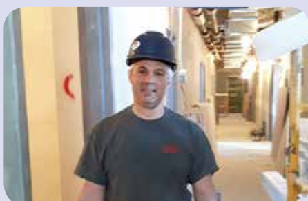
Le confrère Billy Pelletier, de la compagnie Électro (1983) inc, sur le chantier de l'UQAR.
