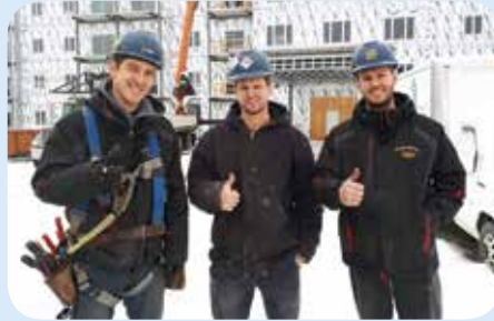
Chantier : Manoir du Quartier, à Saint-Georges, en Beauce. Équipe de travailleurs de Renault Bourque électrique inc.
