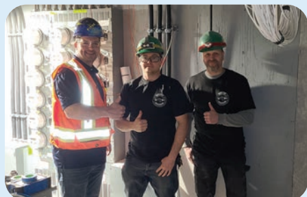
Le confrère Nicolas Parr (représentant), avec les confrères Steve Desruisseaux Houle et Stéphane Pilote, sur le chantier Villa du parc de la paix, à Drummondville.
