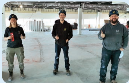
Chantier : Add Énergie. Entrepreneur : Fize électrique. La consœur Joannie Defoy avec les confrères Julien Beauchesne et Pierre Doyon. Représentant : Vincent Baux.
