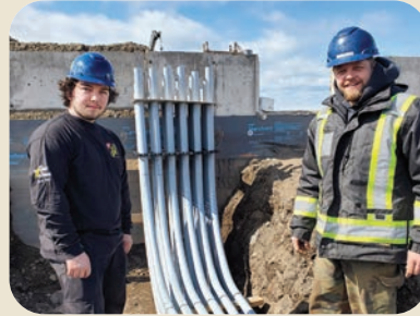
Les confrères Joseph-Adelar Dubé et Louis-Jean Charest, sur le chantier du Moulin, à Cacouna. Entrepreneur : Barrette & fils Ltée.
