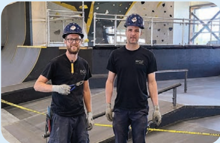
Les confrères Marc-André Levasseur et Keven Cyrenne, sur un chantier à Trois-Rivières, pour la compagnie RGF électrique inc.
