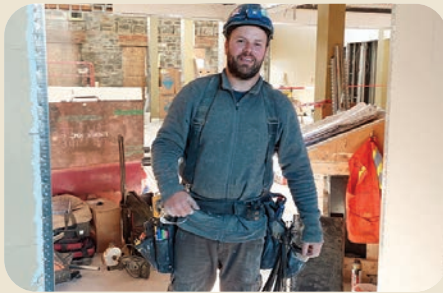
Sur le chantier de la bibliothèque de Rivière-du-Loup, le confrère Dany Chamberland, pour la compagnie Claude Miville inc.
