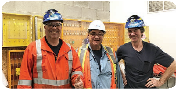
Électriciens au chantier de la mine North American Lithium, à La Corne. Entrepreneur : J.Y. Moreau. Travailleurs : Les confrères Stéphane Papineau, Pierre Leduc, René Taillefer, tous cadenasseurs.
