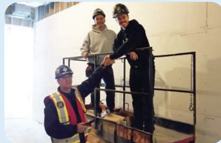
Hôtel Entourage sur-le-Lac, Lac-Beauport. Des travailleurs en systèmes de sécurité et le confrère Guy Roy, représentant syndical par intérim.
