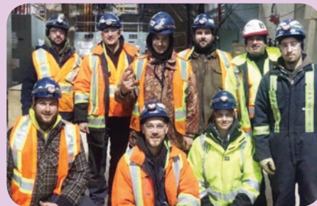
L'équipe du confrère Nicolas Chapados, pour le tirage des câbles, au chantier Ciment McInnis (Entreprise d'électricité Sirois inc.).
