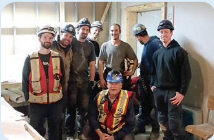
Chantier : Hôtel Entourage sur-le-Lac, au Lac-Beauport. Entrepreneur : AC électricité inc. Contremaître : Tommy Déry.
