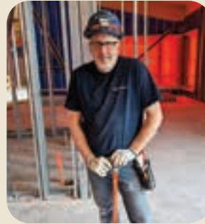
Sur le chantier de la nouvelle Lab-École à Rimouski, le confrère Patrick Thériault, de la compagnie Contrôles AC.
