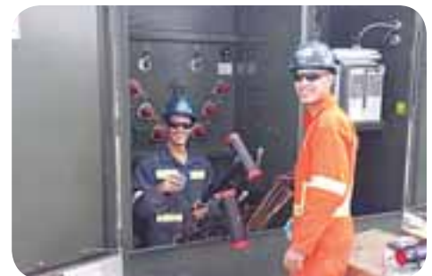
Chantier : parc éolien Rivière-du-Moulin (RDM), préparation de têtes de câbles haute-tension, par les monteurs de lignes.
