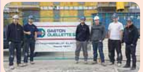
Chantier : Équinox. Entrepreneur : Gaston Ouellette électrique. Contremaître : Mathieu Bernard. Représentant : Robert Cardinal.
